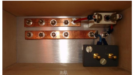
Bild 4 unters Schubfach für die Stromversorgung
